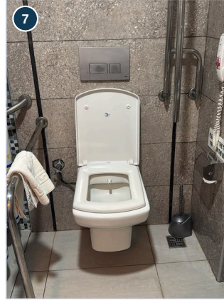
Klozetin iki yanında tutunma barları ve duvar telefonu
