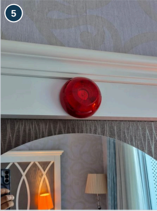
Odada yangın alarm uyarı cihazı
